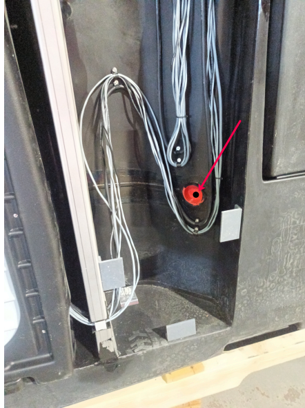
Figure 16 Emplacement du bouchon orange dans le panneau central de l'échangeur
